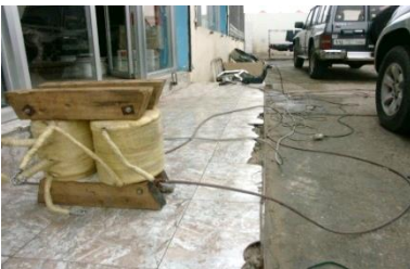
Abbildung 58: Schweissanlage in Afrika
